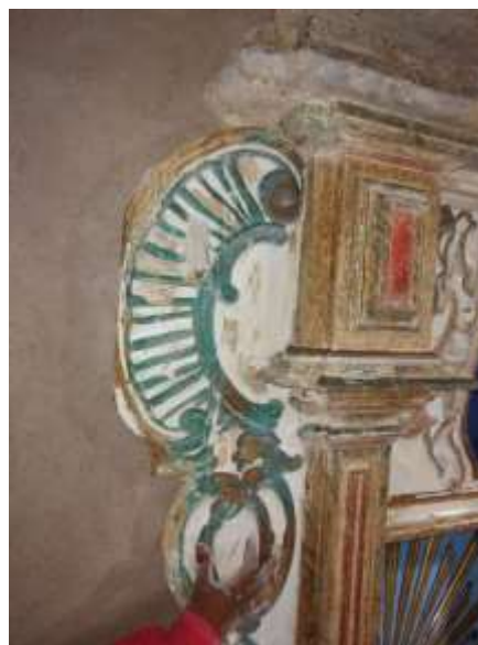
Fig. 6. Aba lateral do retábulo da sacristia, repintura dourada oxidada (esverdeada) devido à salinização da parede.
