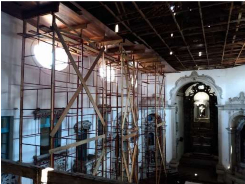
Figura 3. Escoramento das três tesouras partidas, cobertura da nave da Igreja de São José do Ribamar, Recife.
