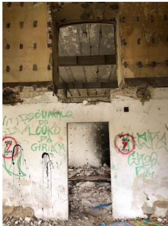
Foto 12 - Paredes internas destruídas
