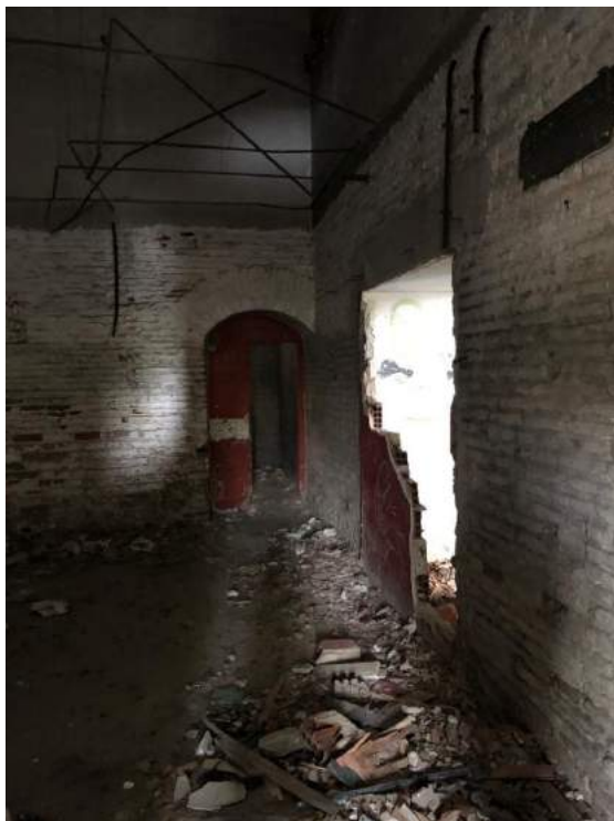
Foto 11 - Paredes internas destruídas
