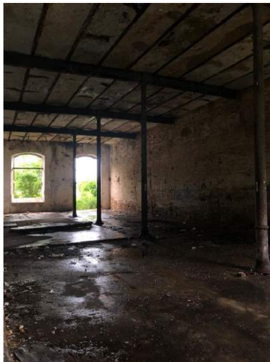
Foto 16 - Presença de umidade na edificação
