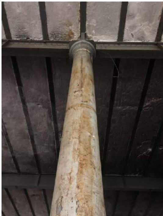
Foto 15 - Estrutura metálica enferrujada e oxidada
