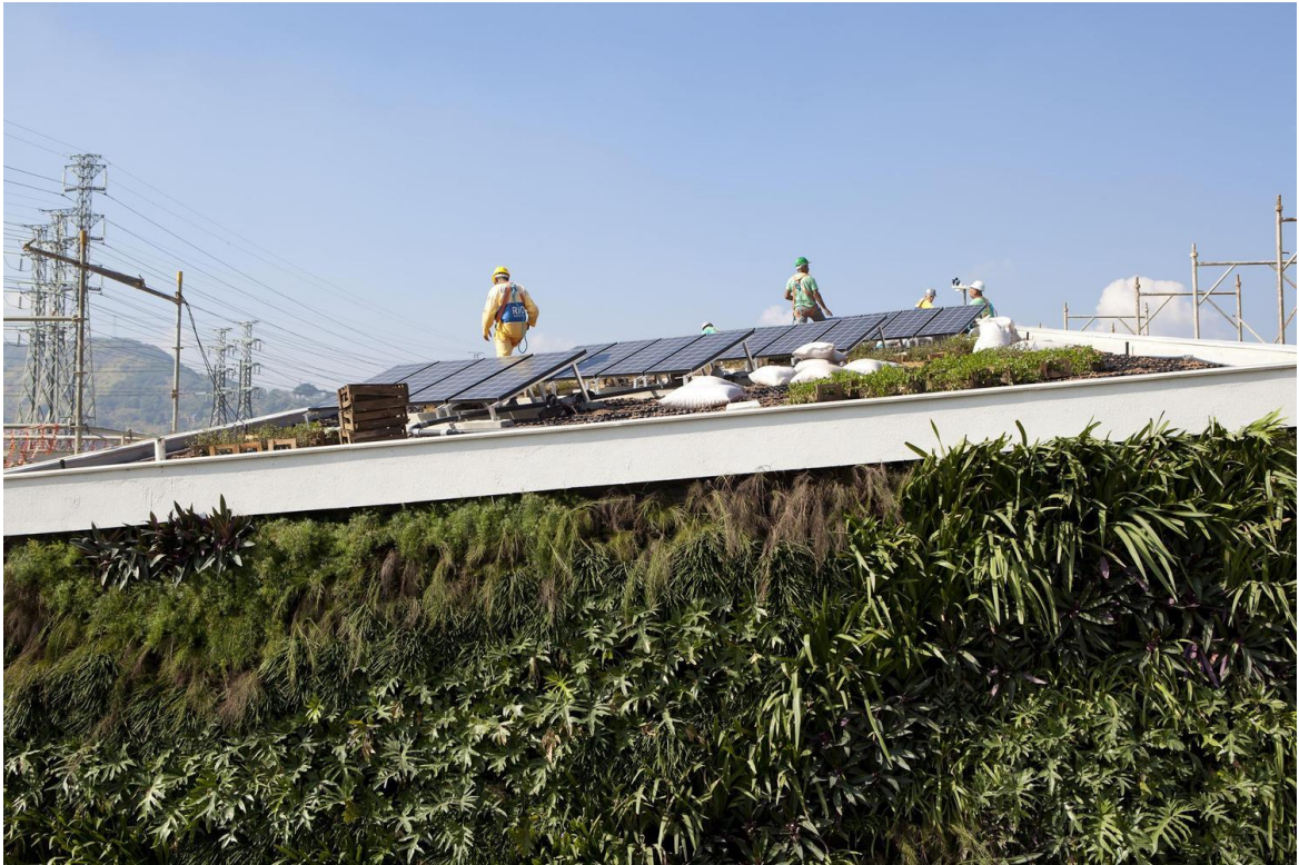
Figura 24 – Placas fotovoltaicas para ajudar na eficiência energética
