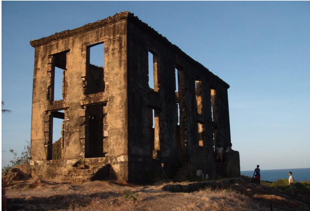
Figura 45 – Ruínas da Casa do Faroleiro.
