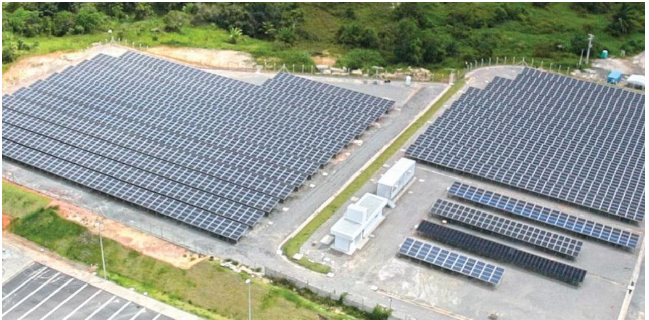
Figura 20 - Placas Fotovoltáicas na Usina Solar São Lourenço da Mata
