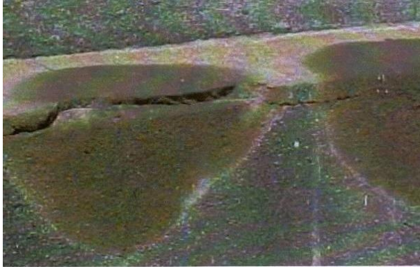
FIGURA 27: Rachaduras e perda de material em partes do contorno da coluna. FONTE: PCR, 2002.
