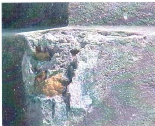
FIGURA 25: Rachaduras e perda de material em partes da base da coluna. FONTE: PCR, 2002.
