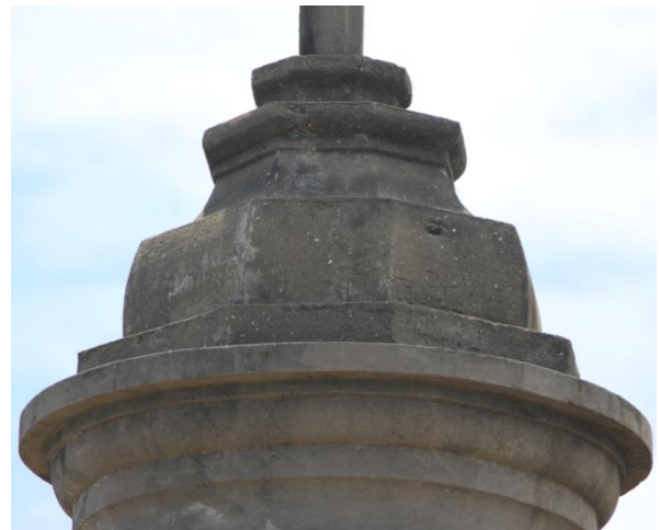
FIGURA 24: Impurezas, rachaduras e perda de material no capitel da coluna. FONTE: Acervo da autora, novembro de 2012.
