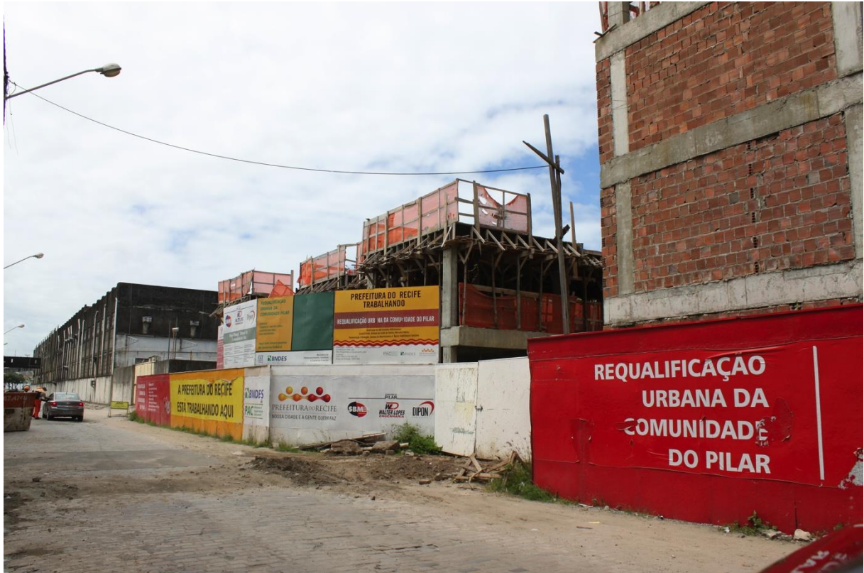
FIGURA 41: Imagens das obras de na Comunidade do Pilar. FONTE: Acervo da autora, setembro/2012
