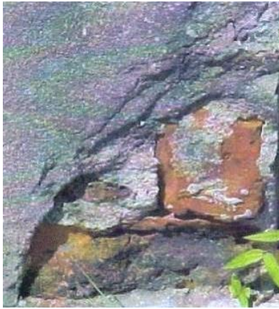
FIGURA 29: Rachaduras e perda de material em partes da base da coluna. FONTE: PCR, 2002.
