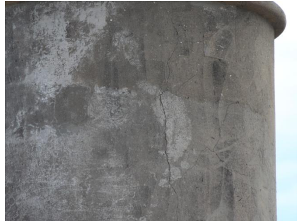
FIGURA 22: Rachaduras em partes do contorno da coluna. FONTE: Acervo da autora, novembro de 2012.
