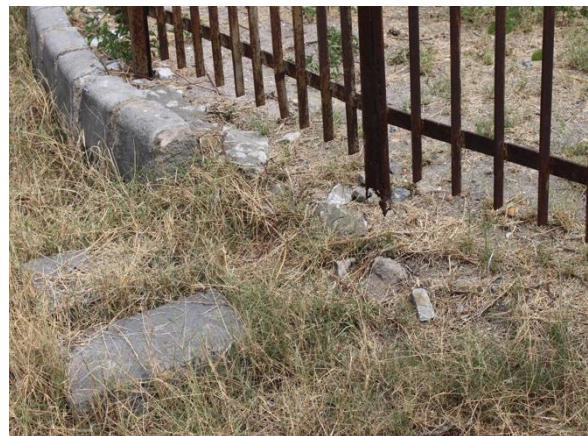
FIGURA 32: Parasitas vegetais na superfície da pavimentação e oxidação e perda de coloração e de material do gradil. FONTE: Acervo da autora, novembro de 2012.
