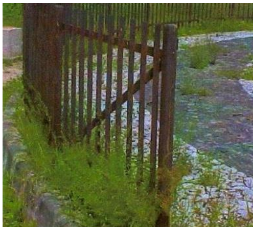
FIGURA 31: Parasitas vegetais na superfície da pavimentação e oxidação e perda de coloração na superfície do gradil. FONTE: PCR, 2002.
