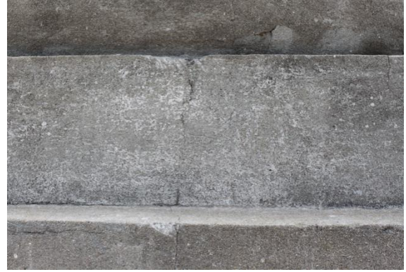
FIGURA 28: Rachaduras em partes do contorno e da base da coluna. FONTE: Acervo da autora, novembro de 2012.
