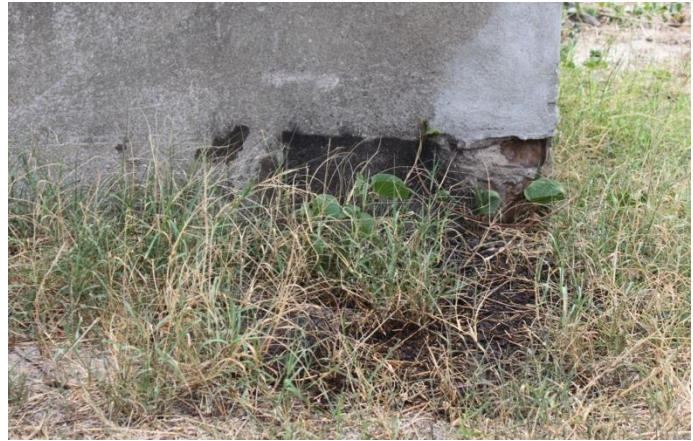
FIGURA 30: Rachaduras e perda de material em partes da base da coluna. FONTE: Acervo da autora, novembro de 2012.
