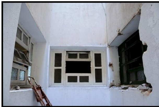
Figura - Vista do exterior do edifício. Janelas altas danificadas, com as paredes depredadas.
