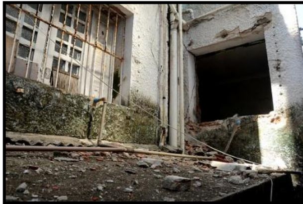
Figura - Estado de abandono do edifício. Com algumas esquadrias faltantes e entulhos.
