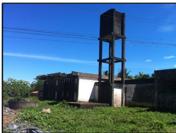
FIGURAS 69: Edificação deteriorada
