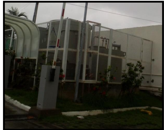
FIGURA 56: Estação de tratamento de Esgoto do grupo Pão de Açúcar
