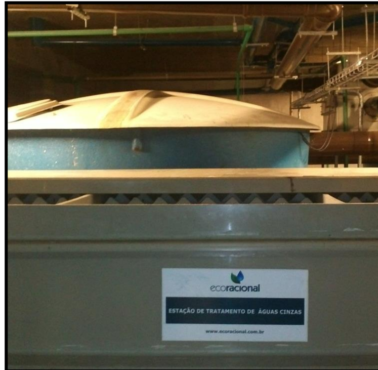
FIGURA 32: Estação de tratamento de águas cinzas.
