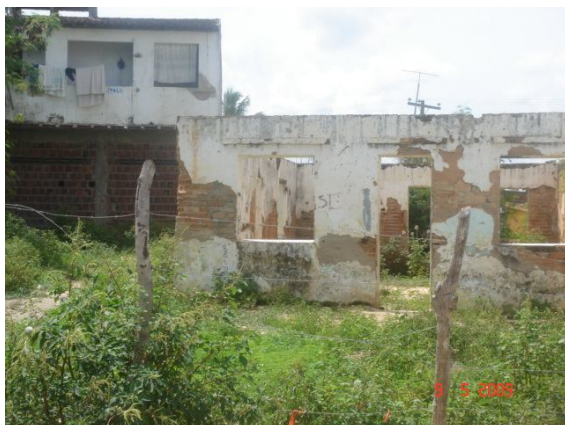
Figura 44: Ruínas da ASSOCIATRA Fonte: Autora, 2010
