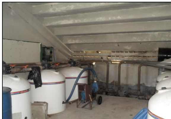
FIGURA 118: Casa de bombas (piscina) FONTE: Acervo da autora, 2012.
