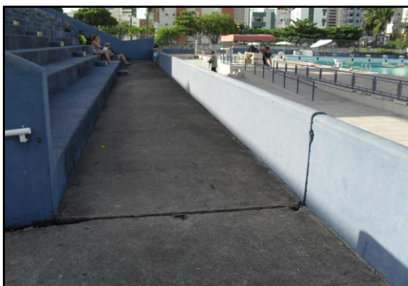
FIGURA 112: Junta dilatação FONTE: Acervo da autora, 2012.
