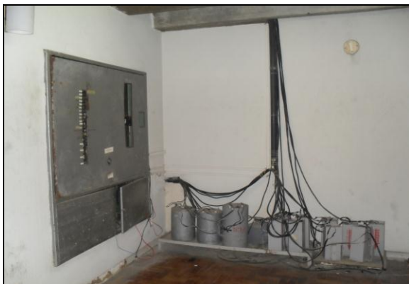
FIGURA 91: Subestação FONTE: Acervo da autora, 2012.
