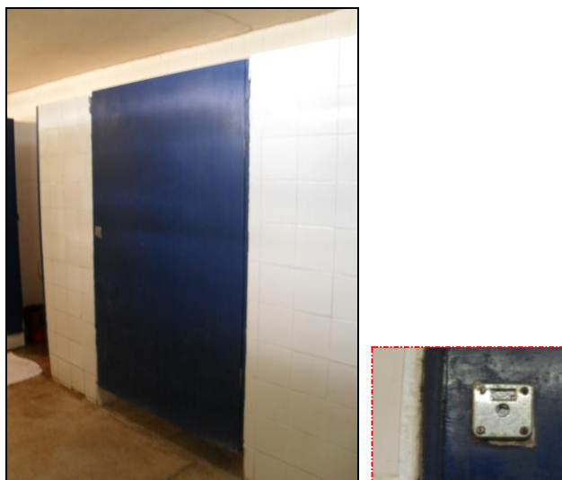
FIGURA 145: Porta Wc P.N.E e detalhe da fechadura FONTE: Acervo da autora, 2012.
