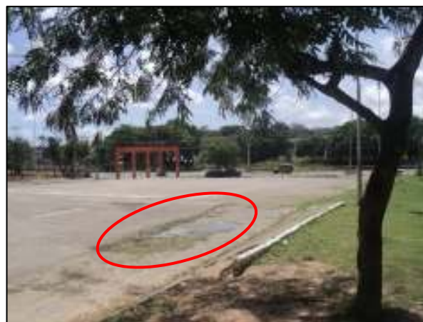
FIGURA 131: Piso degradado no pátio de eventos.
