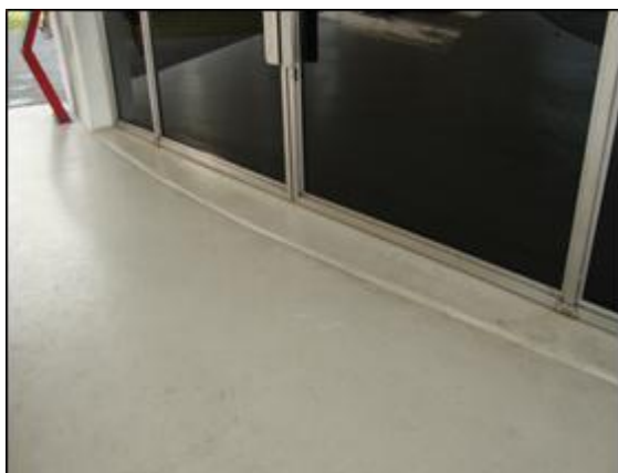
FIGURA : Entrada para a galeria com piso em porcelanato e porta em esquadria de alumínio com folha de vidro.
