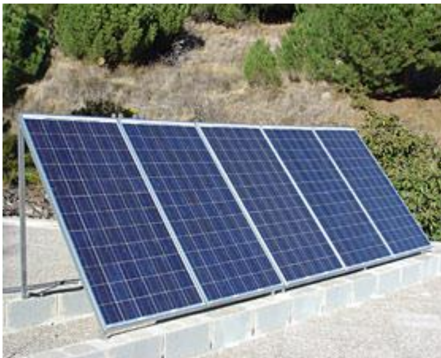
FIGURA 105: Placas Solares. FONTE: Google, 2012.
