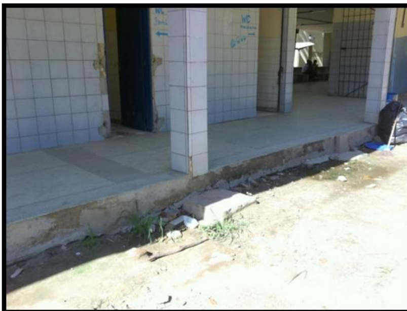
FIGURA 99: Desníveis sem rampas – Escola Cônego Rochaël de Medeiros. FONTE: Autora, 2011.
