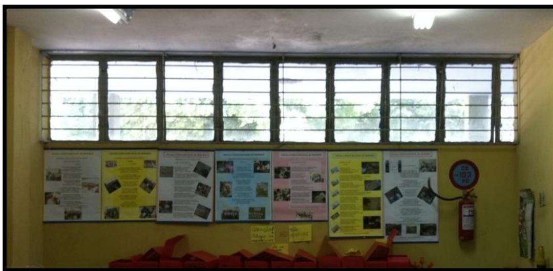
FIGURA 97: Janelas completamente vedadas – Escola Cônego Rochael de Medeiros. FONTE: Autora, 2011.
