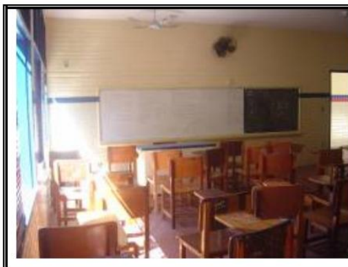
FIGURA 57: Ventiladores - Sala de Aula 07. FONTE: Autora, 2011.
