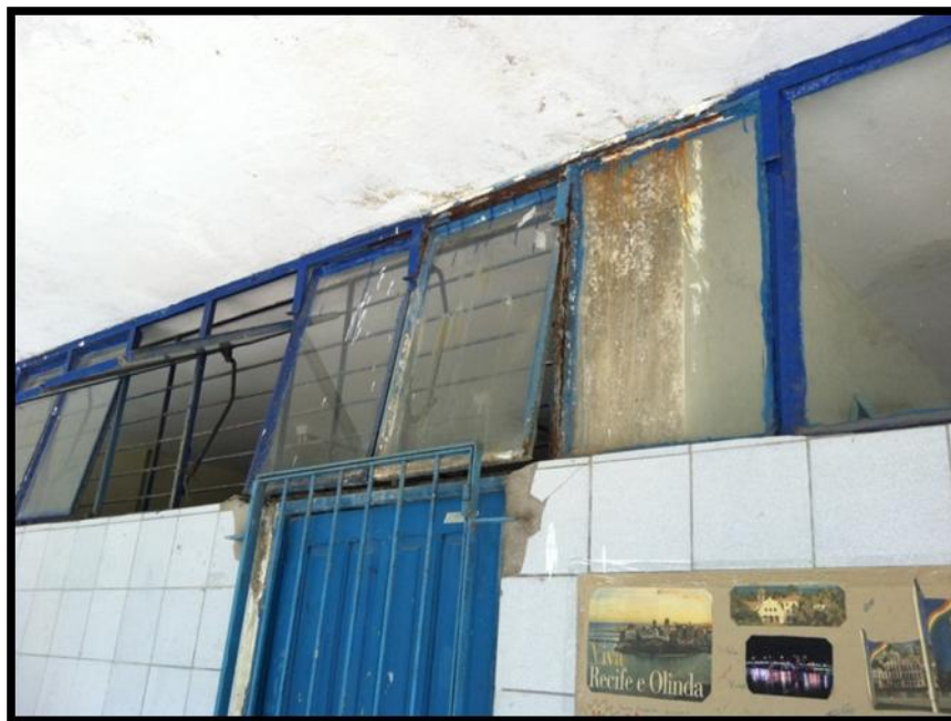
FIGURA 96: Janelas quebradas – Escola Cônego Rochael de Medeiros. FONTE: Autora, 2011.
