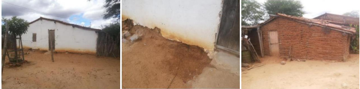
Figura 11 - Habitação vernacular em taipa de sopapo em Floresta. Da esquerda para a direita: vista frontal; detalhe da parede em contato direto com o solo; vista posterior sem revestimento e com rachaduras
