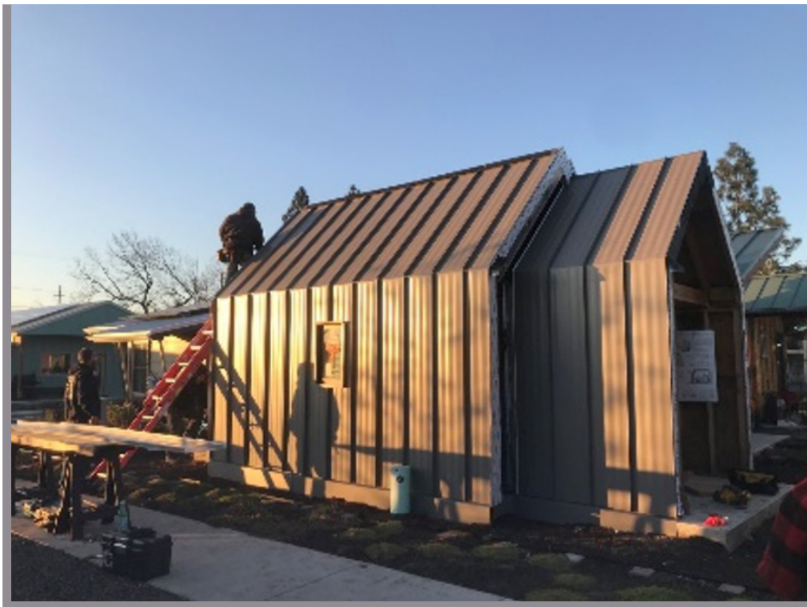
Figura 53 ■ Telhado e estrutura do modelo da tiny house metálico com desempenho de alta performance. Fonte ■ Square One Villages, 2021.
