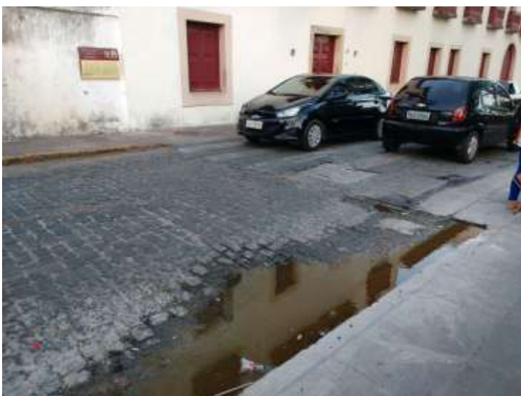
FIGURA 78: Rua Bispo Coutinho – Grelha obstruída.
