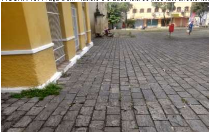
FIGURA 13: Praça Dom Adauto e a ausência de piso tátil direcional.
