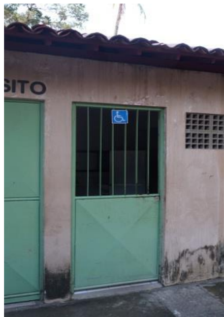
FIGURA 82 - SINALIZAÇÃO DE PORTAS TÁTIL
