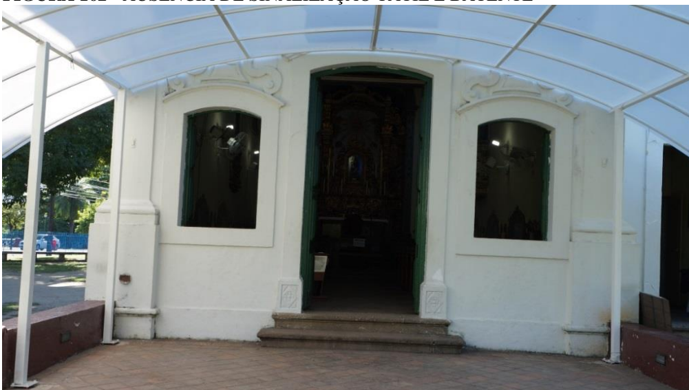
FIGURA 162 - AUSÊNCIA DE SINALIZAÇÃO TÁTIL E BATENTE
