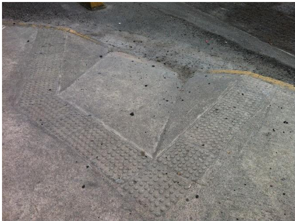
FIGURA 25: Rampa de acesso irregular. FONTE: Autora, 2015.
