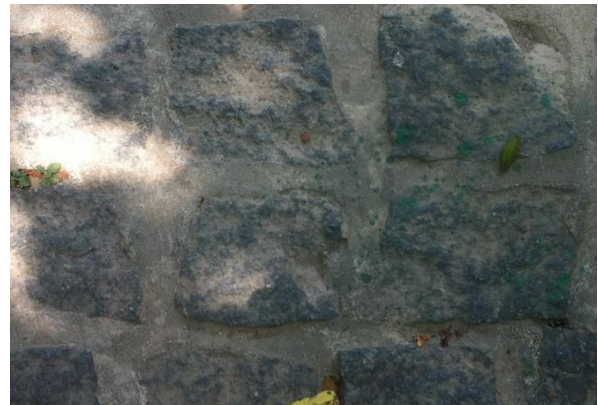
FIGURA 32: Piso não aconselhável.
