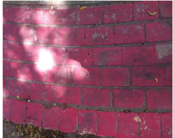
FIGURA 40: Piso de revestimento não indicado e sem manutenção. FONTE: Autora, 2015.
