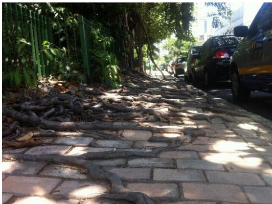
FIGURA 33: Raízes comprometendo a passagem.
