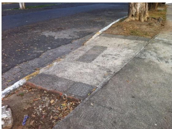
FIGURA 45: Rampa de cadeirante fora dos padrões da norma. FONTE: Autora, 2015.
