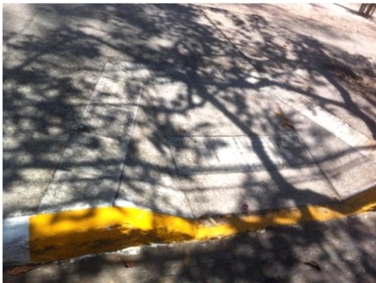
FIGURA 50: Calçada não atende a faixa mínima. FONTE: Autora, 2015.
