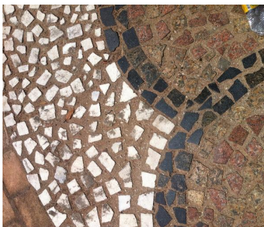
FIGURA 14: Piso com revestimento inadequado. FONTE: Autora, 2015.
