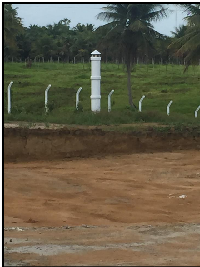
FIGURA 49: Chaminé para eliminação dos gases
