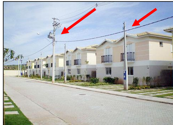
FIGURA 17: Postes em Concreto
