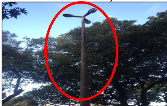
FIGURA 64: Poste de Iluminação
