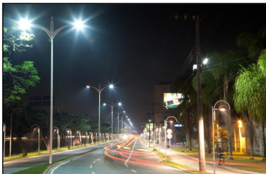
FIGURA 174: Postes de Iluminação
