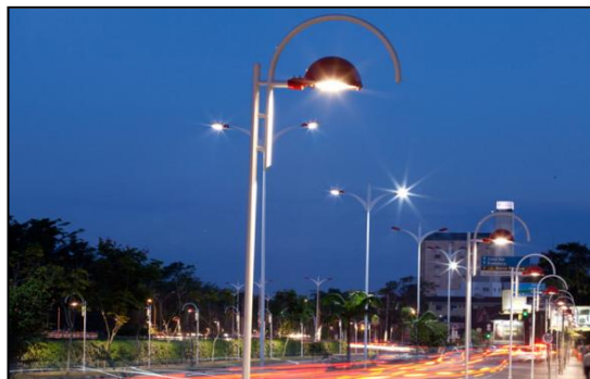
FIGURA 175: Postes de Iluminação
