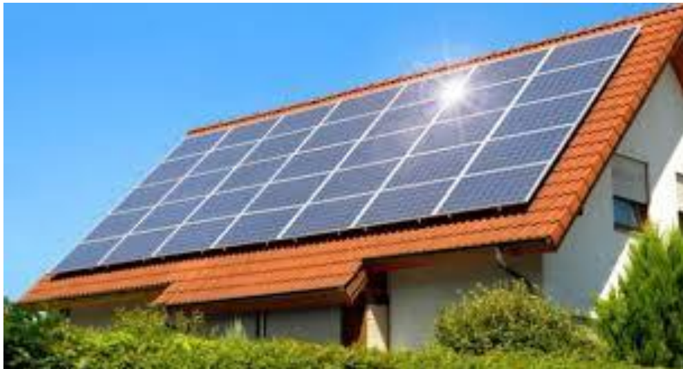
FIGURA 1: Painéis solares instalados em uma residência.
