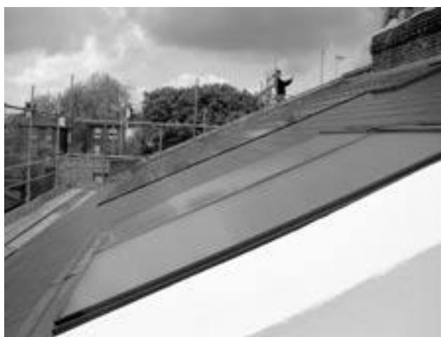
Figura 55: Painéis fotovoltaicos instalados no telhado para geração no local de energia renovável. Fonte: Cassar, 2009, p. 9.
