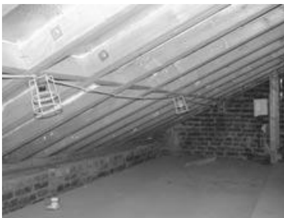
Figura 52: Redução da infiltração de ar na Casa Vitoriana de Baixa Energia (LEVH – Low Energy Victorian House) através da reconstrução do telhado utilizando silicone para selar as juntas entre painéis solares e entre as vigas.
