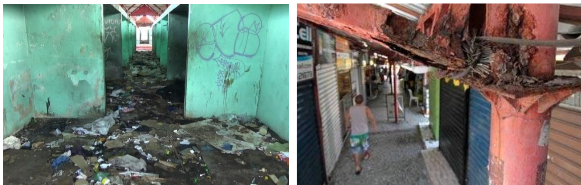
Figura 45 e 46 - Situação atual do Camelódromo: Piso superior cheio de lixo, estrutura degradada.
