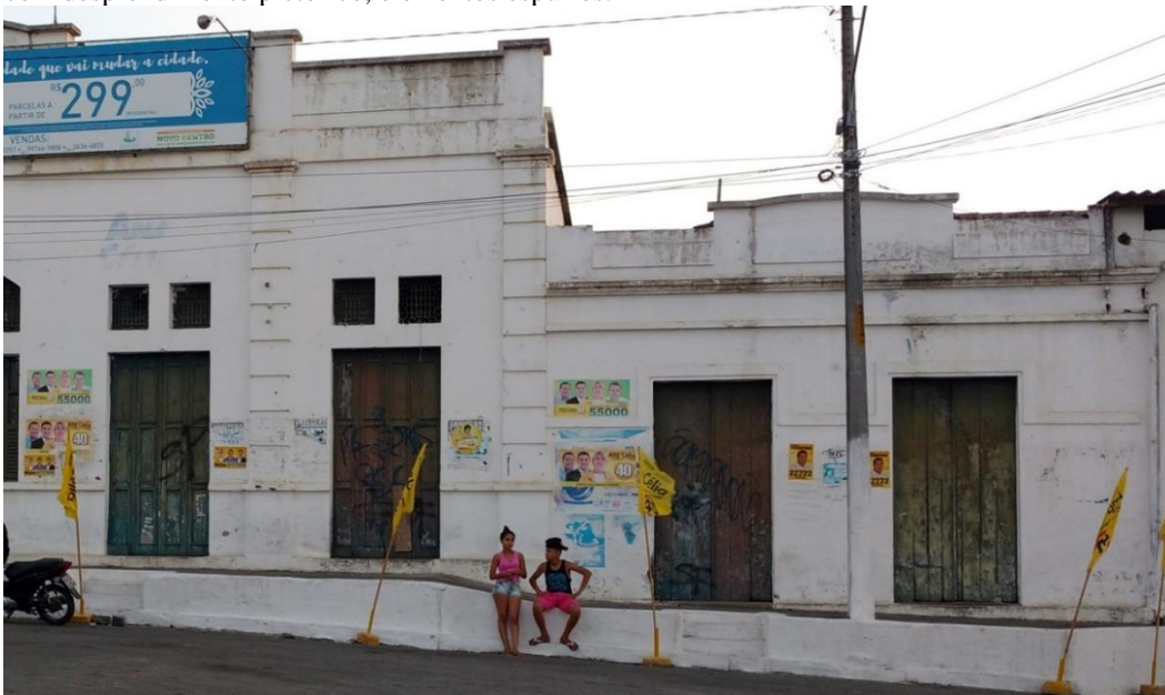
Figura 45: Desprendimento da camada pictórica, crosta negra, oxidação da ferragem, esquadrias em madeira com desprendimento pictórico, elementos espúrios.
