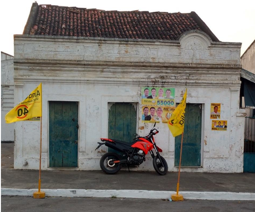
Figura 48: Elementos espúrios, desprendimento da camada pictórica, crosta negra.
