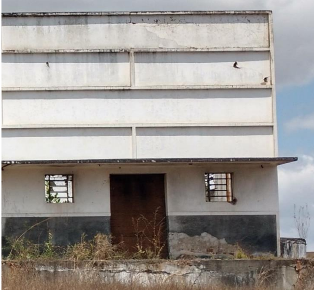
Figura 44: Desprendimento do reboco da camada pictórica, oxidação da ferragem, perda de vidro, crosta negra, rachaduras superficiais, sujidades e presença de vegetação.
