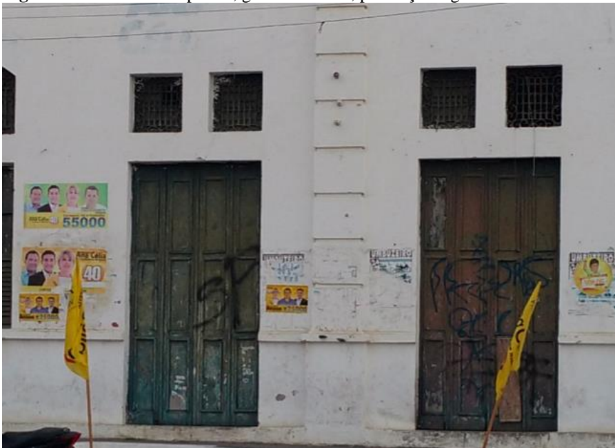
Figura 47: Elementos espúrios, gradis oxidado, presença de grafismo.
