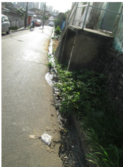
Figura 8: Esgoto a céu aberto no Alto José do Pinho
