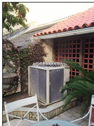
Figura 122 - Equipamento em “laje técnica”
