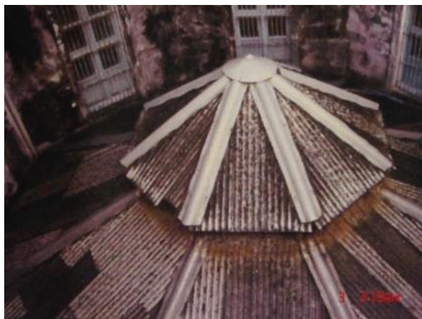
Figura 17: Coberta antes da reforma
