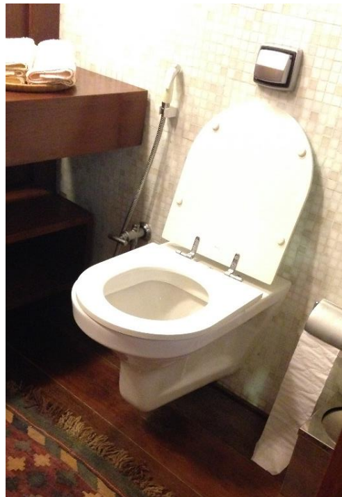
Figura 63: Bacia sanitária suspensa com tubulação de parede
