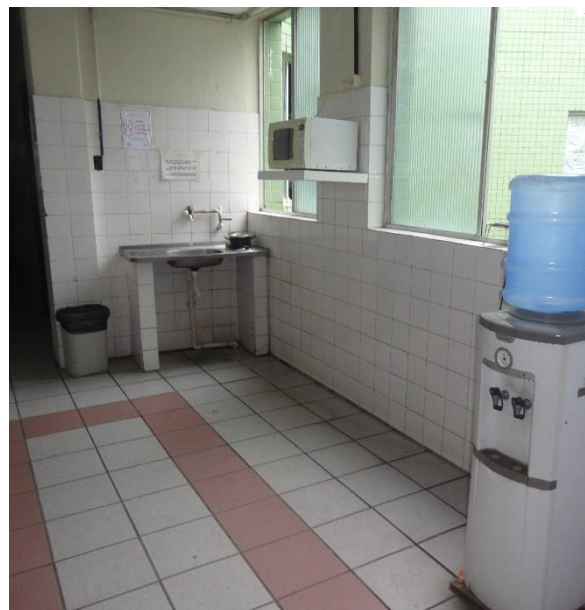
Figura 30 - Copa improvisada no corredor dos quartos
