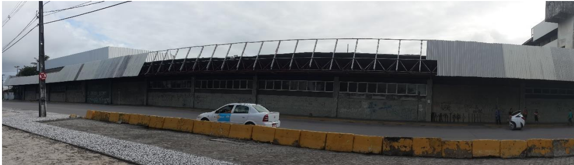
Foto 47: Oxidação na estrutura metálica.
