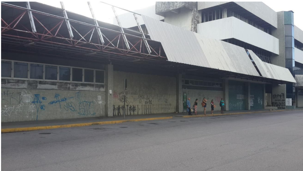
Foto 46: Ações de vandalismo no antigo Aeroporto dos Guararapes.
