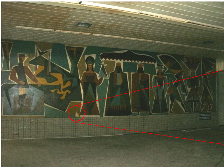
Foto 48: Presença de cupins deteriorando painel artístico.
