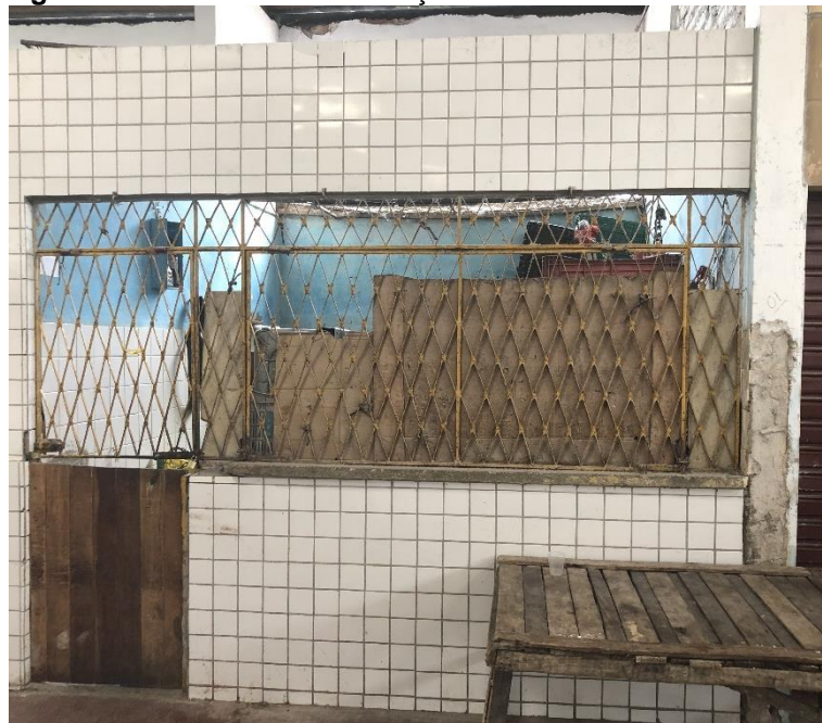
Figura 18: Boxes sem manutenção
