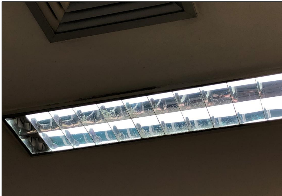
Figura 27. Luminária da circulação com acúmulo de pó
