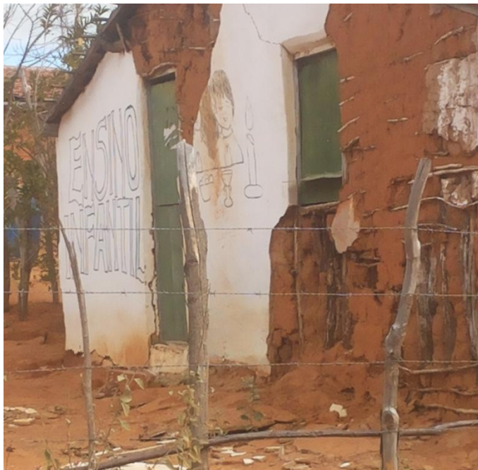
FIGURA 233 – Detalhe da fachada, Escola construída em Pau-a-Pique, revestida em areia e cal
