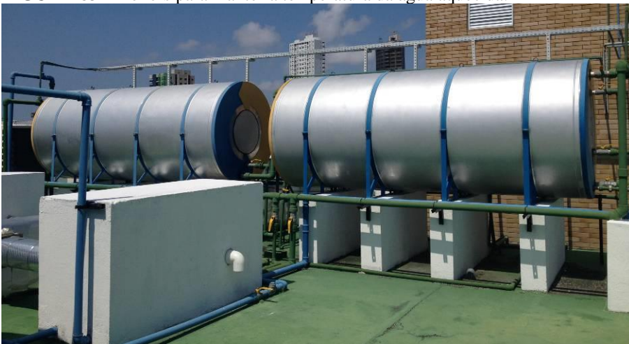
FIGURA 83 – Boilers para manter a temperatura da água aquecida.
