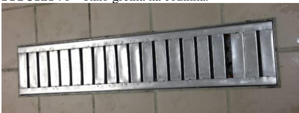
FIGURA 76 – Ralo grelha na cozinha.
