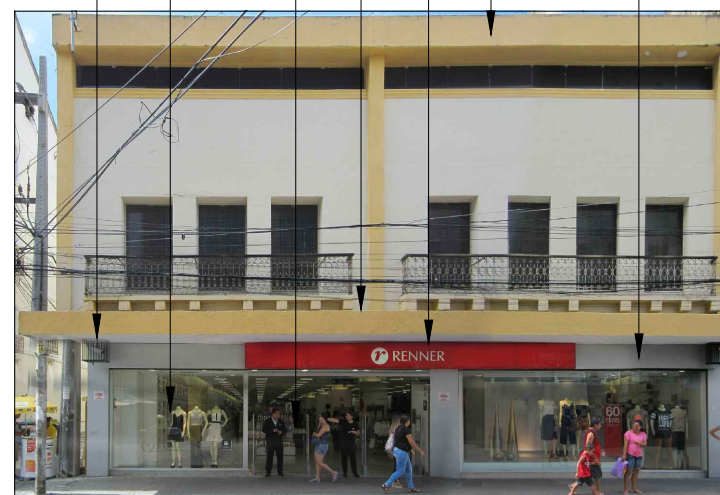
ESTADO ATUAL DA FACHADA DA EDIFICAÇÃO DE N° 163
