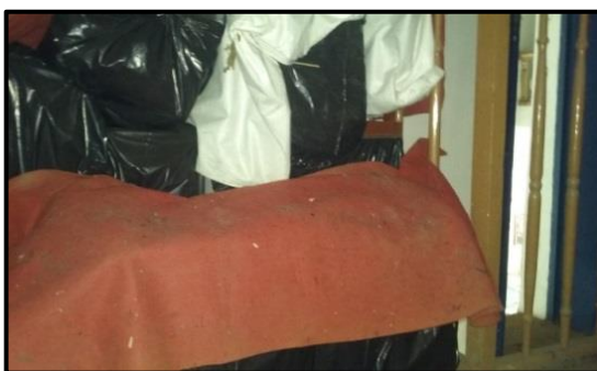
Figura 61: Material depositado indevidamente na Galeria
