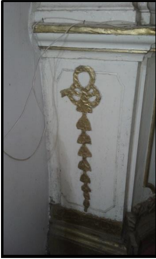
Figura 54: Instalação elétrica inadequada.
