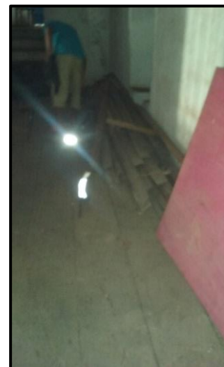
Figura 60: Uso indevido da Galeria.
