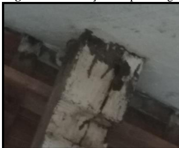
Figura 43: Presença de cupim - viga
