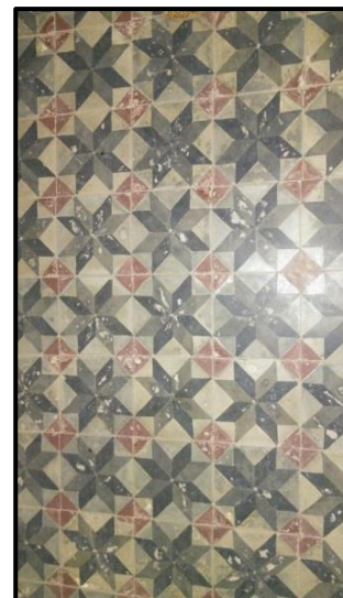
Figura 86: Desgaste do piso.
