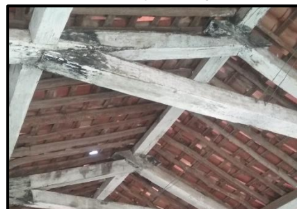
Figura 44: Presença de fungos - tesoura
