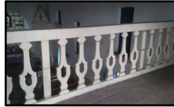
Figura 65: Deterioração por umidade.
