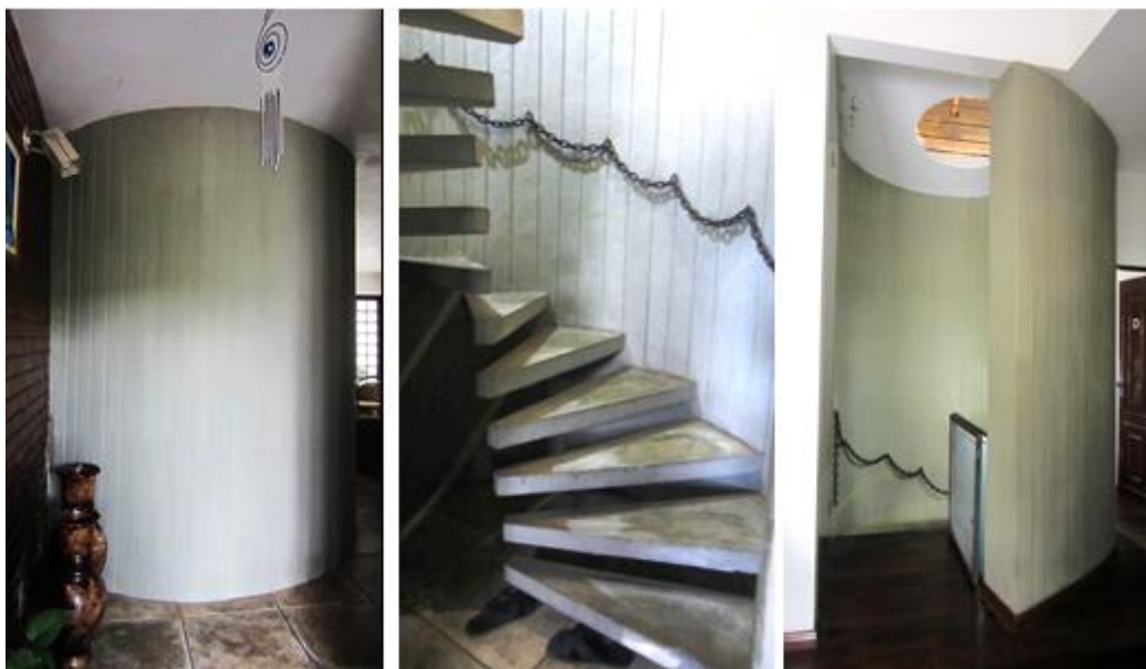
Acesso ao pavimento superior – Proteção semicircular da escada e degraus em concreto
