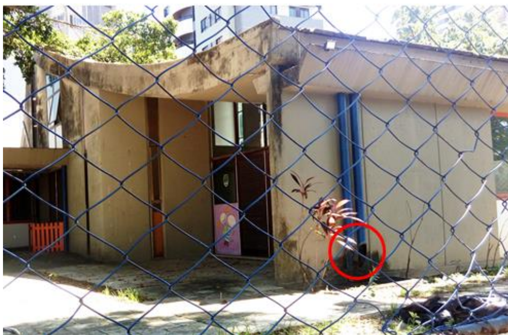
Terraço Frontal- detalhe da calha e dos canos de ferro cortados transversalmente, para escoamento da água da calha
