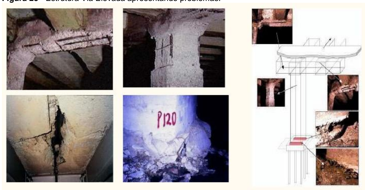
Figura 23 - Estrutura Via Elevada apresentando problemas.
