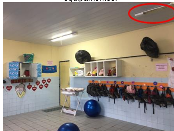
Figura 46 - Falta manutenção nos equipamentos.
