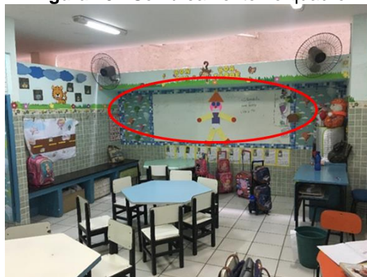
Figura 43 - Sombreamento no quadro
