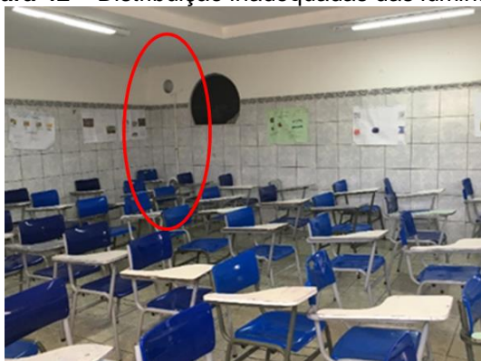
Figura 42 – Distribuição inadequadas das luminária.
