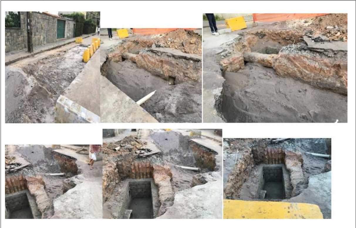
Imagem 4 - Manutenção nas galerias de drenagem de águas pluviais, Rua Jerônimo de Albuquerque
