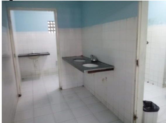
Figura 56 – Área do lavatório externo do banheiro da enfermaria masculina.
